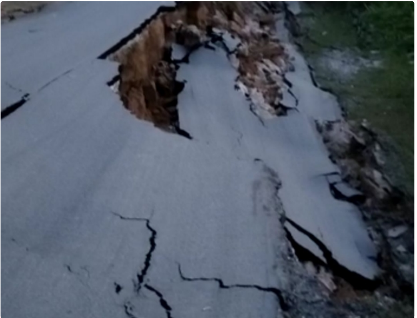
Kondisi Jalan Menuju Ke Jembatan Batu Mahasur Kuala Kurun, Gunung Mas
